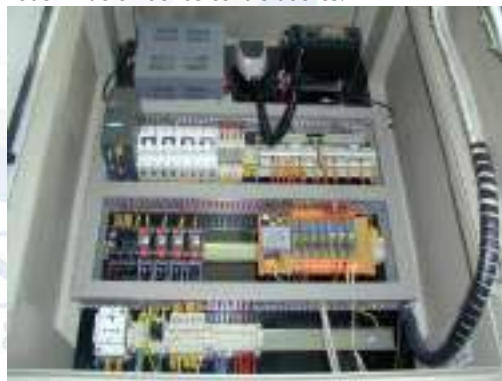
Imagen 2.- Armario de control con emisora de Trunking
