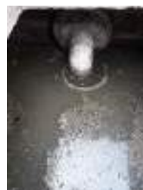
Entrada a la fosa séptica
