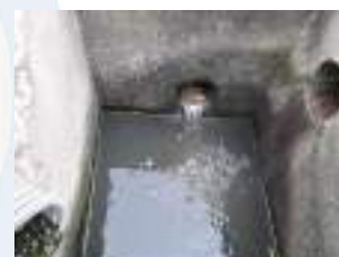
Salida del filtro anaerobio
