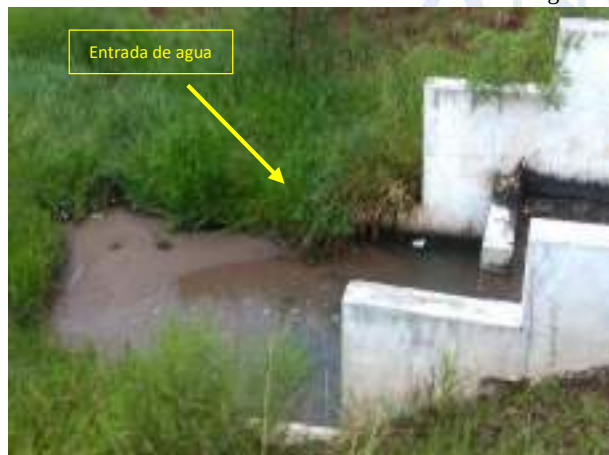
Fotografía 11. Depósito 2 – Entrada de agua (Mar/2018)
