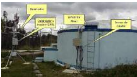
Figura 5. Estación de monitoreo de tanques de reserva.
