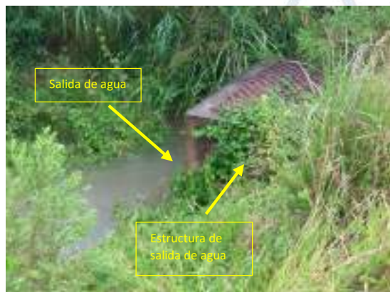
Fotografía 6. Depósito 1 – Salida de agua en día lluvioso (Mar/2018)
