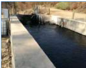
Fotografía 1. Punto provisorio de dosificación de carbón activado en polvo.
