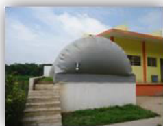
Figura 1. Biodigestor máxima capacidad de llenado
